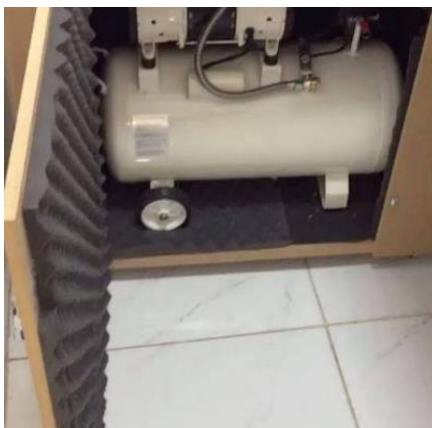
FIG.02- Compressor em local próprio
